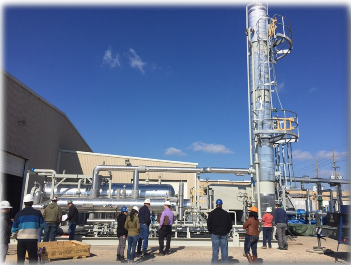
6000 BPD Stabilizer Skid
